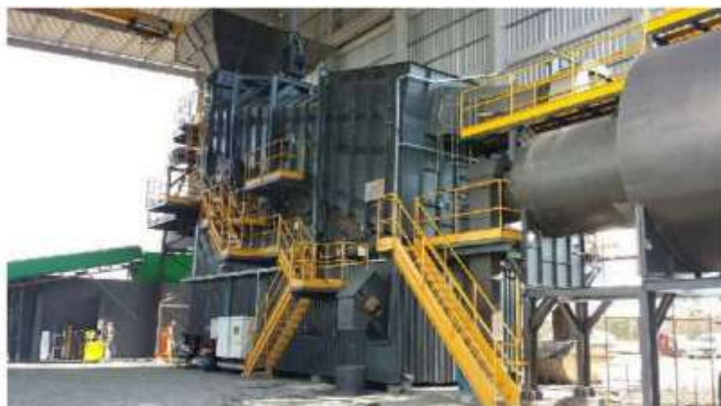
FIGURA 1 – GASEIFICADOR DE RESÍDUOS SÓLIDOS URBANOS
